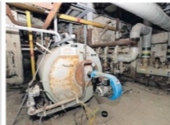
Im Keller gibt es für Nostalgiker einiges zu entdecken, etwa eine riesige Heizungsanlage.
